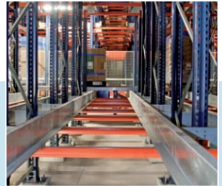
Stockage par accumulation à chariot satellite
